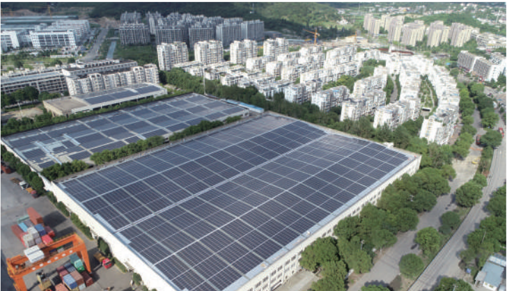
30MW Usina Fotovoltaica BIPV da Jintian Copper Ningbo, Província de Zhejiang, China
