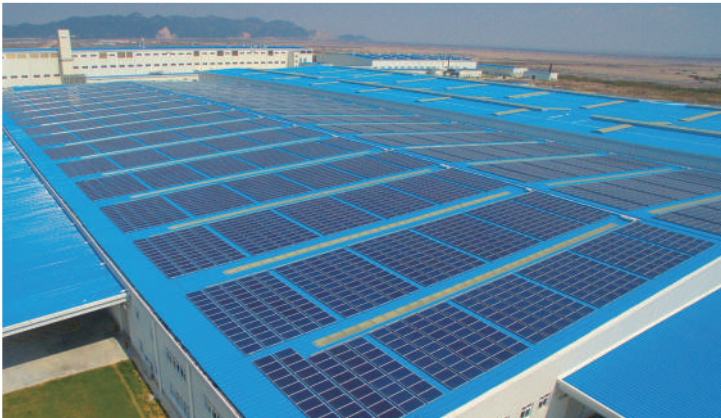
10.3MW Telhado da Geely Automobile em Linhai Linhai, Zhejiang Province, China
