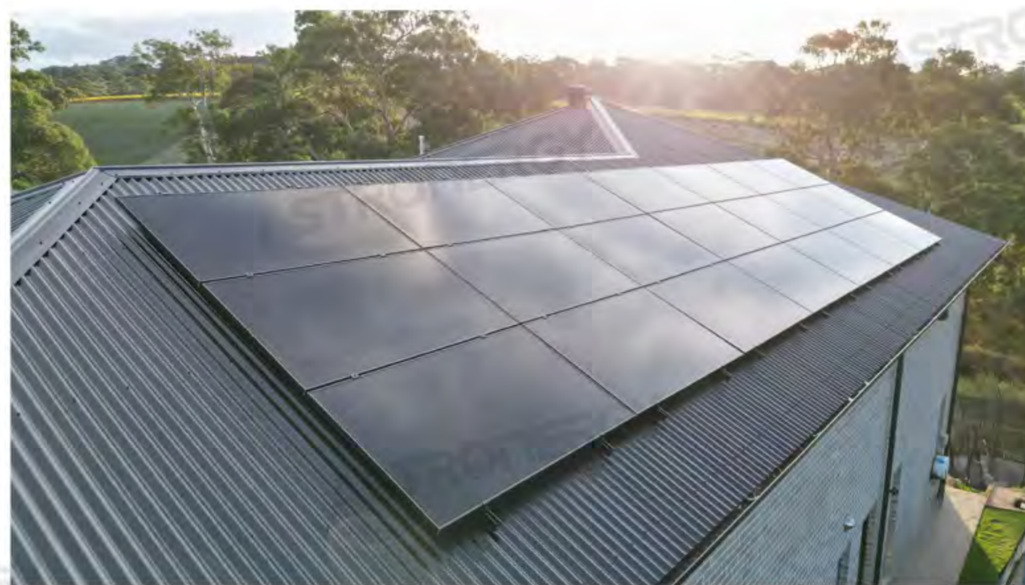
德国 12kW 别墅屋顶项目
