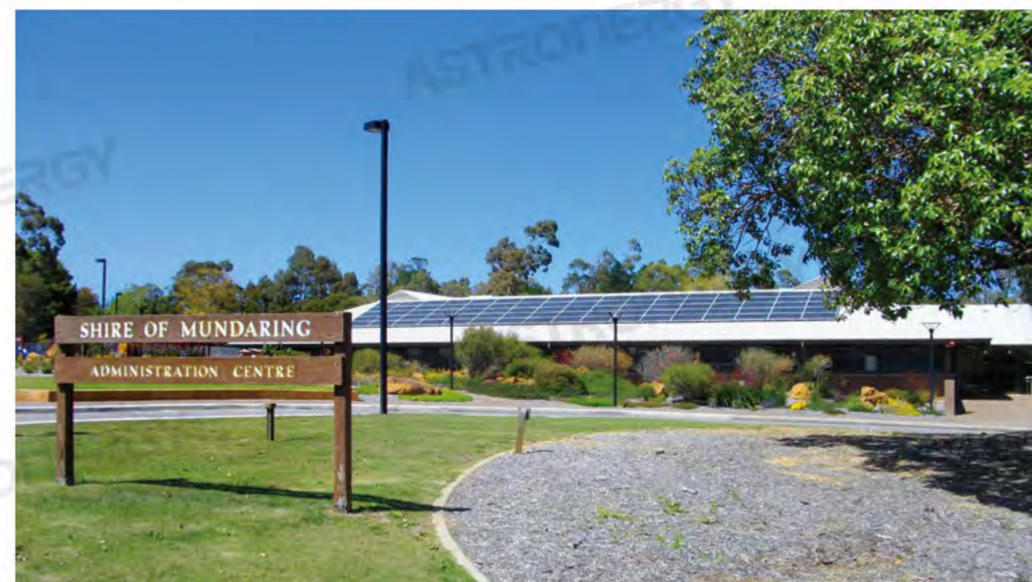
澳大利亚 赫维湾屋顶光伏电站 16kW
